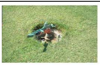
[NO] 관개시설 장치가 외부로 노출되어 있음(안전 미확보)
