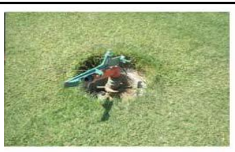
[NO] 관개시설 장치가 외부로 노출되어 있음(안전 미확보)
